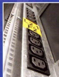
Система энергоснабжения большой мощности
